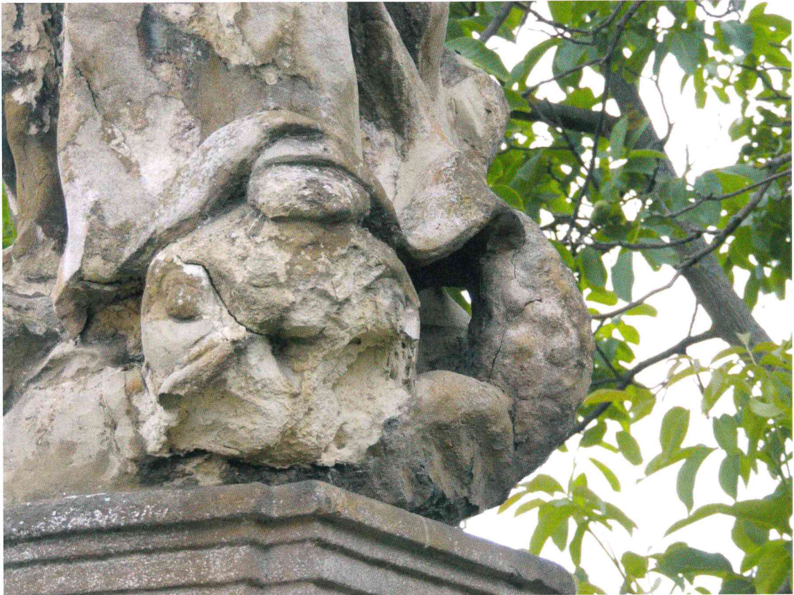
Kostomlaty n. Labem, socha sv. Jana Nepomuckého, detail trhliny a opadávající hmoty kamene v dolní části sochy světce – stávající stav
